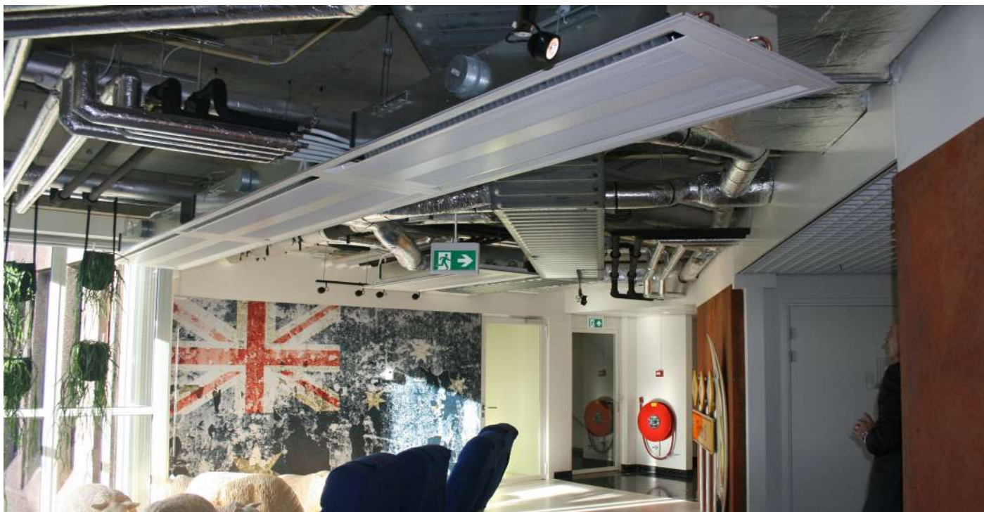
Vrijhangende inductie-units in kantoorpand Booking.com Amsterdam.
