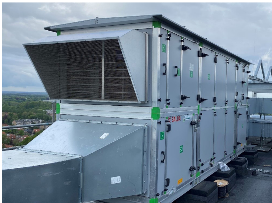
Figuur 8: luchtbehandelingskast in buitenopstelling
